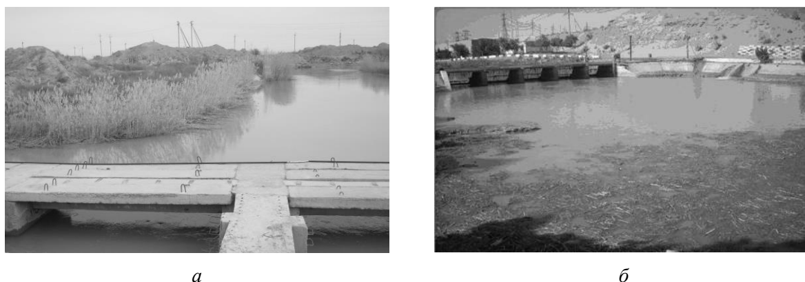
Рисунок 1 – Состояние водоподводящих сооружений ирригационных насосных станций: а – заиление откосов подводящего канала; б – скопление плавника в аванкамере (фото НИИИВП)
