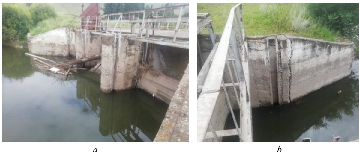
a – вид на входную часть водосброса; b – вертикальная трещина на береговом устое a – view of the inlet part of the spillway; b – vertical crack on the side wall
