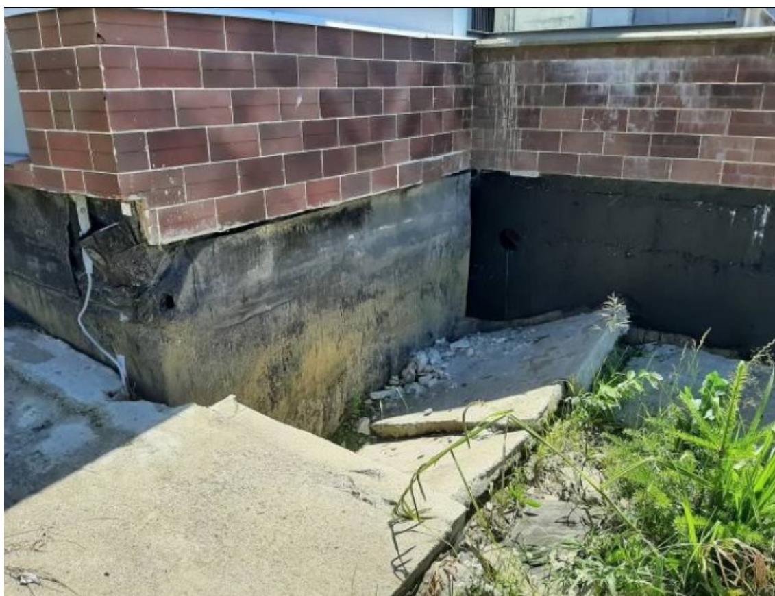
Рисунок 2 – Обнажение фундамента здания (проседание грунта) (автор фото У. Р. Сидаравичуте)
