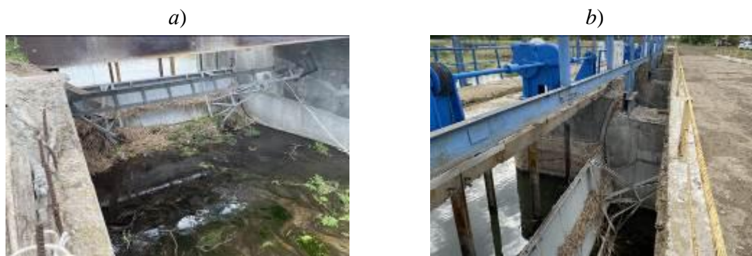
a – скопление мусора за затвором; b – состояние быков и затворного механизма a – debris accumulation behind the gate; b – state of the abutment and breach mechanism
