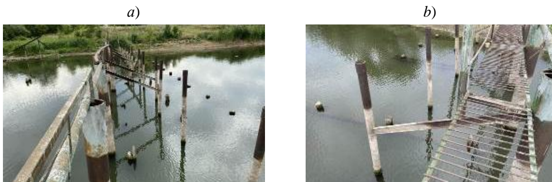
a – отсутствие части пролета ледореза; b – состояние переходного мостика a – absence of a part of the ice cutter span; b – state of the transition bridge
