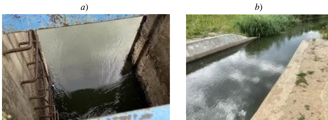
a – вид на нитку трубопровода; b – магистральный канал a – view of the pipeline; b – main channel
