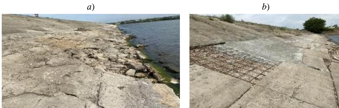
a – вид на низовой откос; b – ремонтные работы по укреплению тела плотины a – view of the downstream slope; b – repair work on strengthening the dam body
