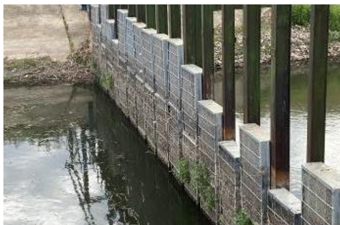
Рисунок 6 – Состояние заполненного керамзитом кассетного рыбозаградительного устройства (автор фото А. Ю. Гарбуз)
