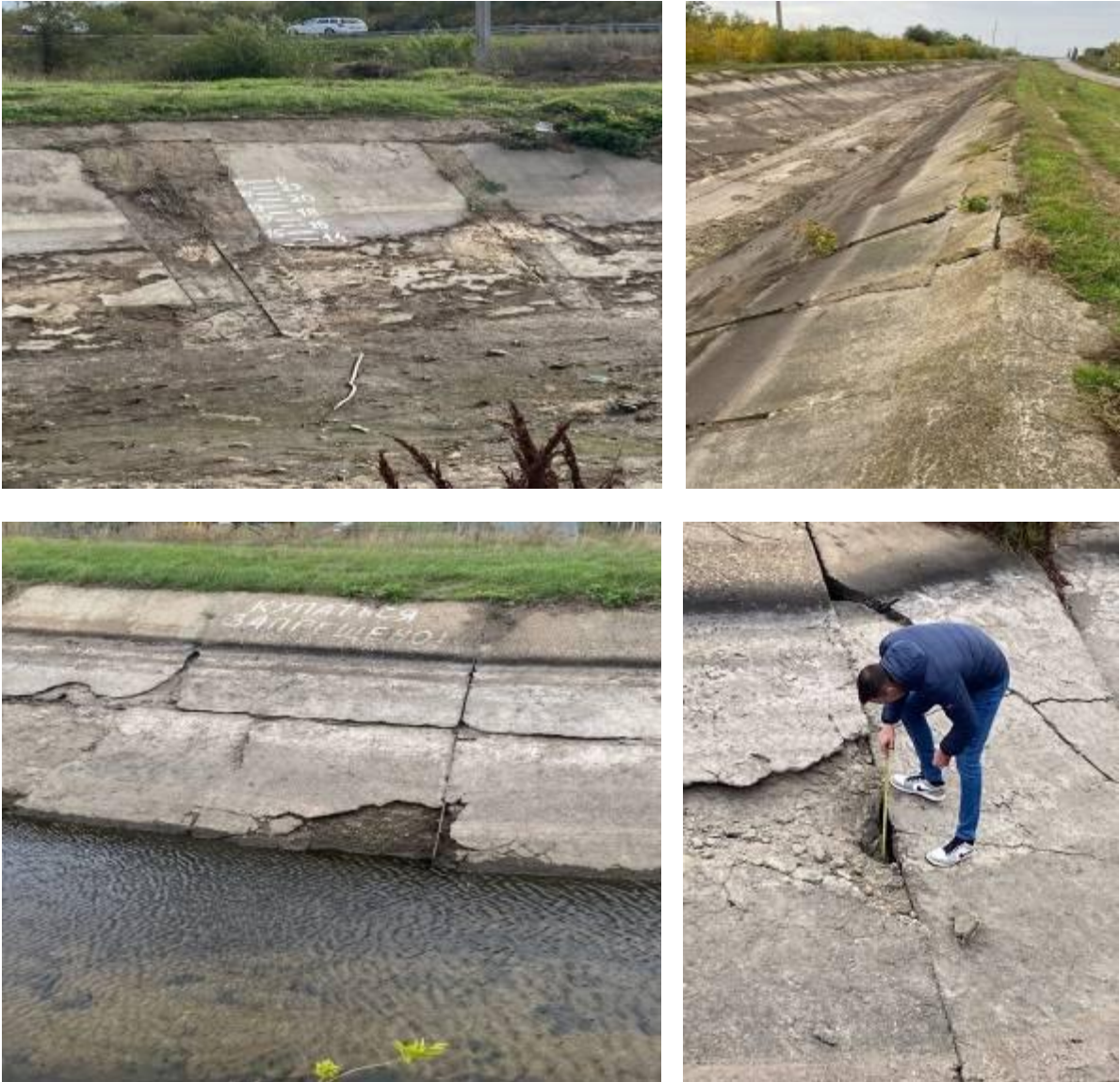
Рисунок 1 – Повреждения противофильтрационного покрытия магистрального канала 1-й очереди Энгельсской оросительной системы (автор фото Э. Э. Сафин)
